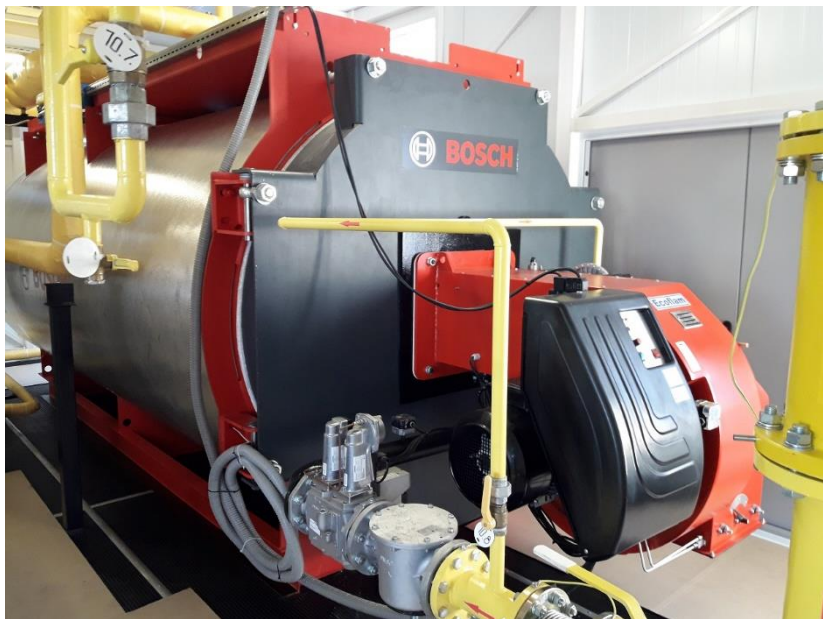
Блочно-модульная котельная, Московская область, горелка BLU 8000.1 PR TL.
