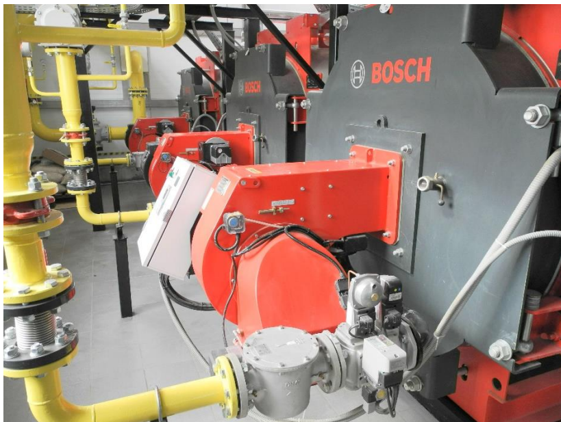
Блочно-модульная котельная, республика Калмыкия, горелки BLU 6000.1 PR TC.
