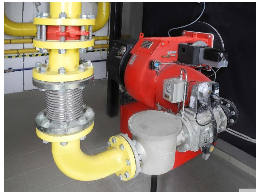
Крышная котельная, г. Волгоград, котлы Ecomax NC 3000 и горелки BLU 4000.1 PR TL.
